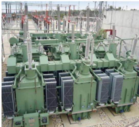
Ввод 36–420 кВ на автотрансформаторе в Португалии
