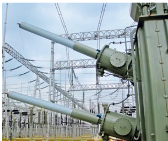
Ввод постоянного тока 250 кВ на преобразовательном трансформаторе в Китае
