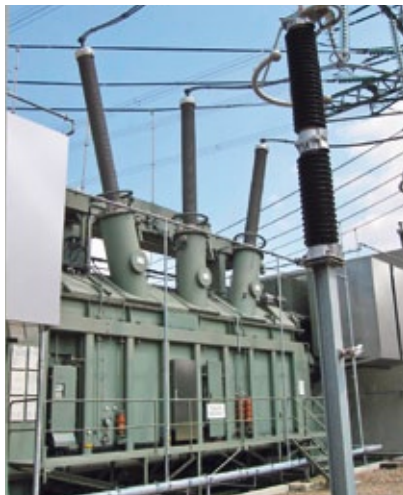
Ввод 420 кВ на сетевом трансформаторе в Германии
